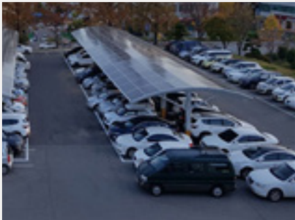
동해시청 주차장 태양광발전설비
